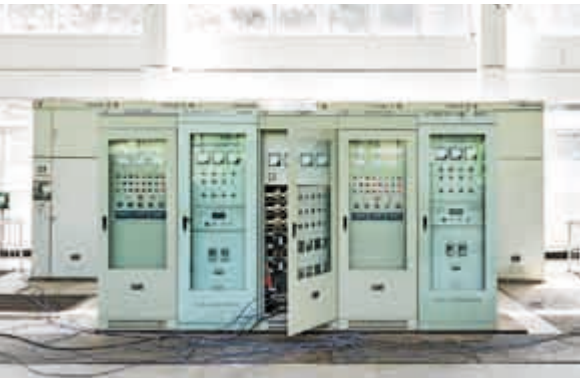
La centrale de commande dans la salle des machines.
