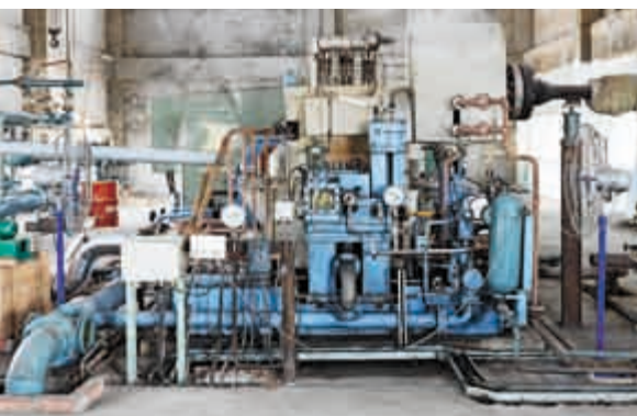
La turbine de l'installation, d'une capacité de 3,66 MW.
