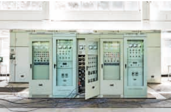
Die Schaltanlage im Maschinenraum.
